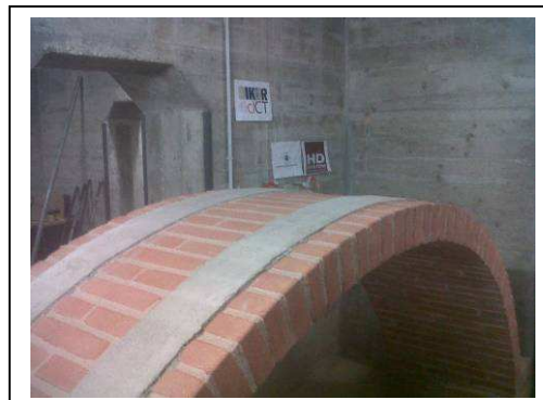
Test di rinforzo su estradosso di volta in mattone pieno con TD13K a supporto delle fibre di acciaio
